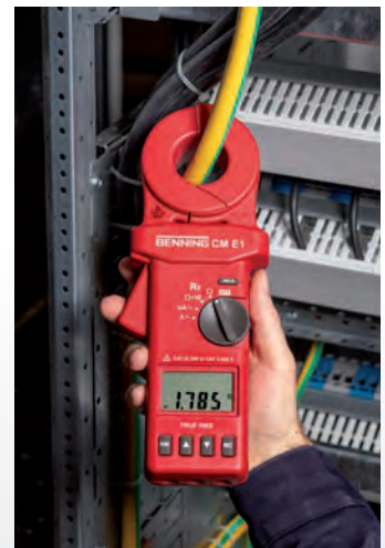
Messung des Betriebserders einer Industrieverteilung
