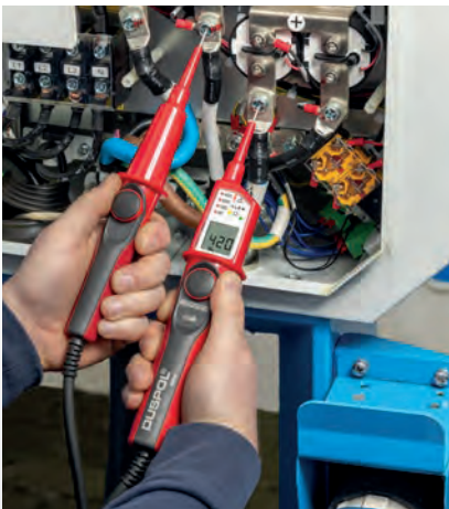
Prüfung der Ausgangsspannung einer DC-Ladeeinrichtung
