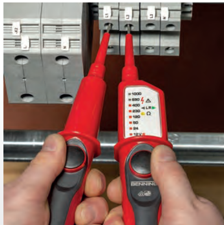
Drehfeldprüfung an den Ausgangsklemmen einer USV
